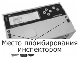
б) Пломба инспектора снабжающей организации
